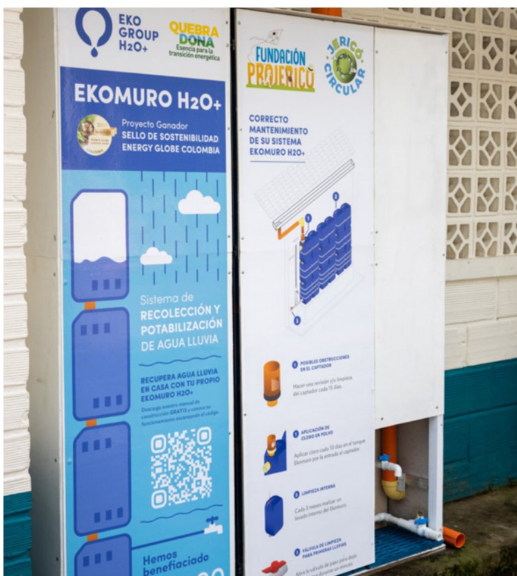
Ekomuro instalado en la Escuela Anexa de la Normal Superior de Jericó
